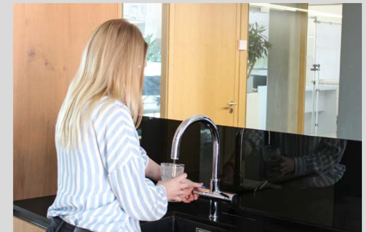
Eine Trinkwasseranlage wurde in allen Teeküchen installiert. Das spart Wasserflaschen.
