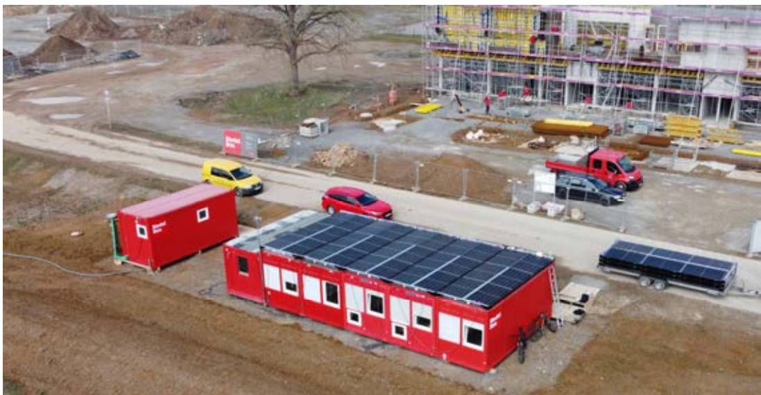
Bild: Baustellencontainer mit mobilen PV-Anlagen
